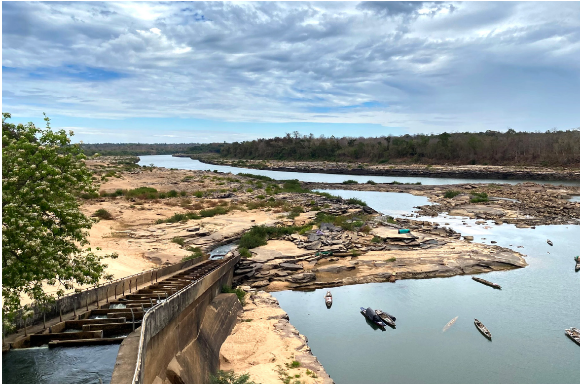
Gambar 16. Tangga Ikan Tidak Berfungsi.
